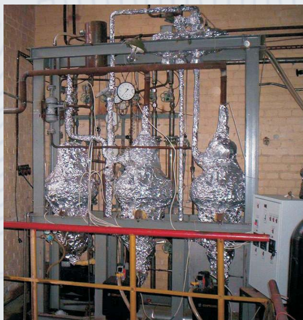
Установка получения синтез-газа под давлением 6,4 МПа
